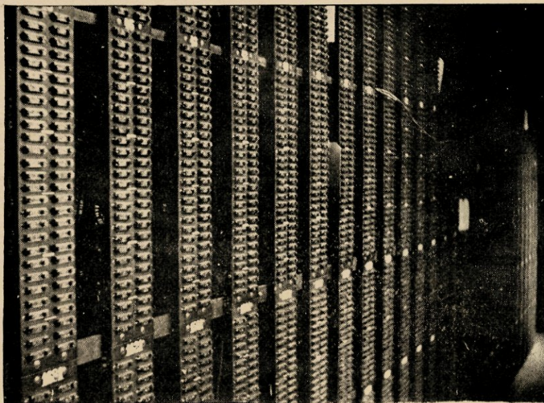
Een der omschakelrekken.
